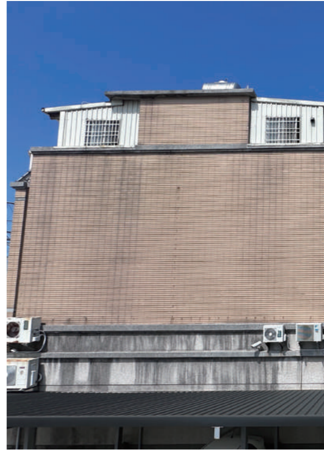
竹南 | 油性止水劑案例 | 沒施作 (左) 有施作 (右) 至 2028 已 20 年
